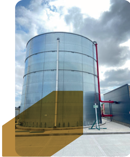
Tanque PCI Instalaciones
